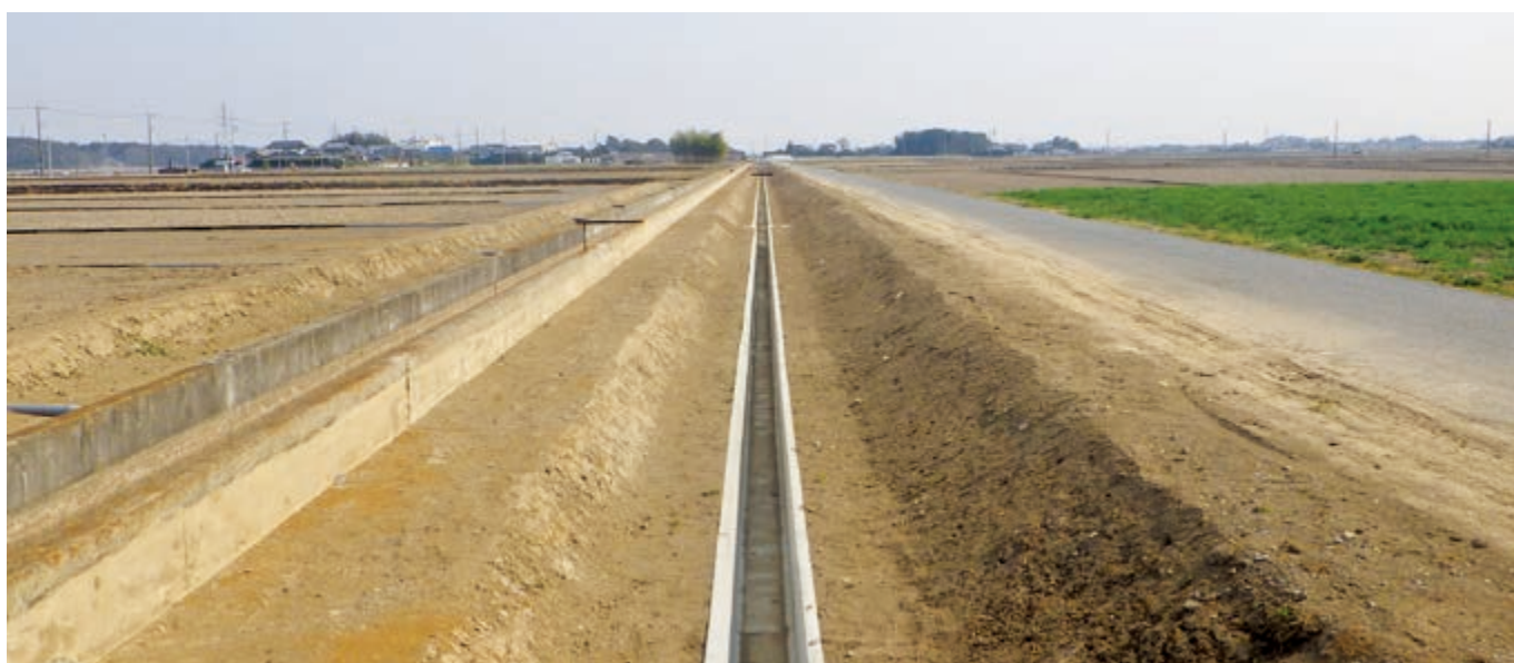
県営経営体育成基盤整備事業伊奈北部地区 小張地先 施工前(上)・施工後(下)
